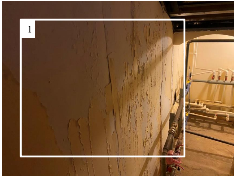
Фото №4. Фрагмент вида стены. Дефекты: 1 - нарушение целостности отделочного слоя.
