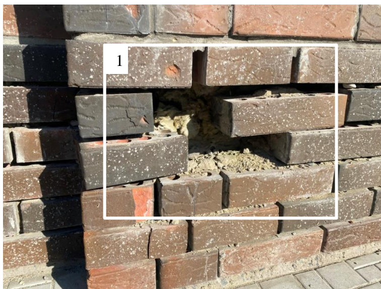
Фото №1. Фрагмент вида цоколя. Дефекты: 1 - нарушение целостности кладки.
