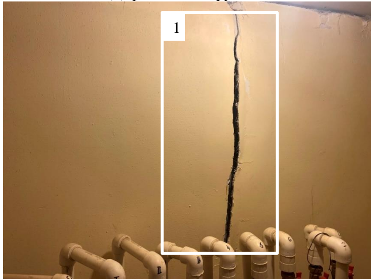
Фото №5. Фрагмент вида стены. Дефекты: 1 - нарушение целостности ГКЛ.
