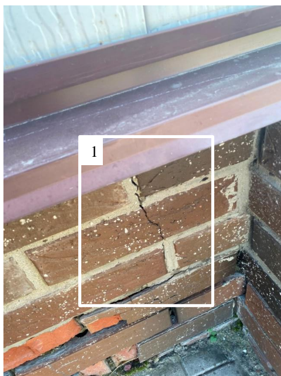
Фото №3. Фрагмент вида цоколя. Дефекты: 1 - трещина по кладке.
