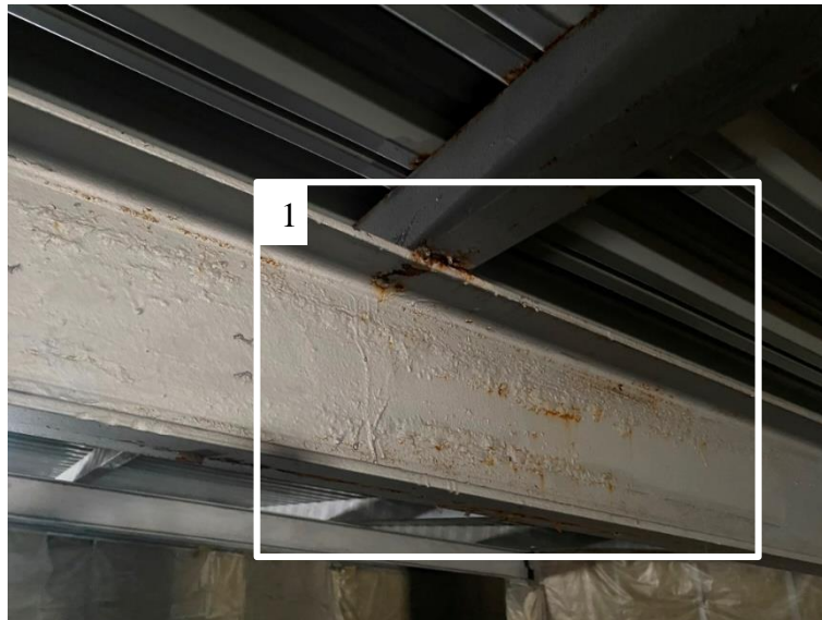
Фото №10. Фрагмент вида крыши. Дефекты: 1 - коррозия металла.
