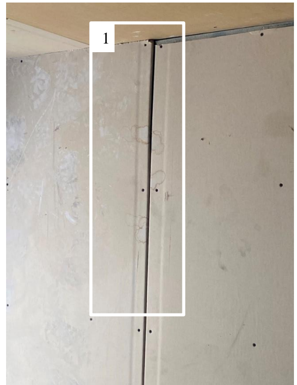
Фото №9. Фрагмент вида потолка. Дефекты: 1 - следы течи.
