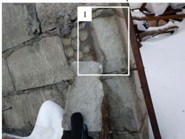
Фото 9. Фрагмент вида стены. Дефекты: 1-сколы газобетонных блоков
