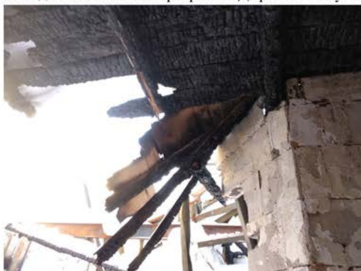
Фото 2. Фрагмент вида межэтажного перекрытия. Дефекты: 1-обугленные элементы.
