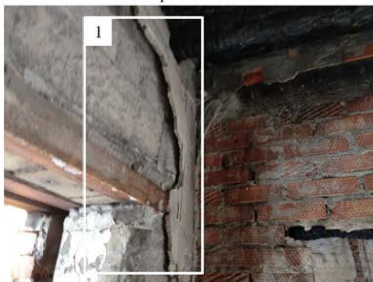
Фото 5. Фрагмент вида стены и потолка. Дефекты: 1-повреждение штукатурного слоя.
