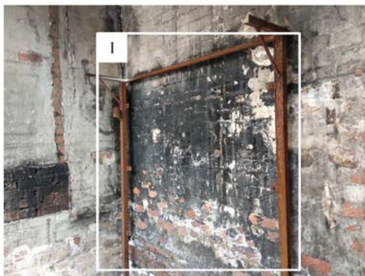
Фото 20. Фрагмент вида перегородки. Дефекты: 1-копоть на кирпичях.
