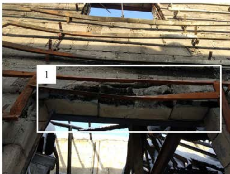
Фото 16. Фрагмент вида стены. Дефекты: 1-отсутствие уголка перемычки, сколы, провисание газобетонных блоков
