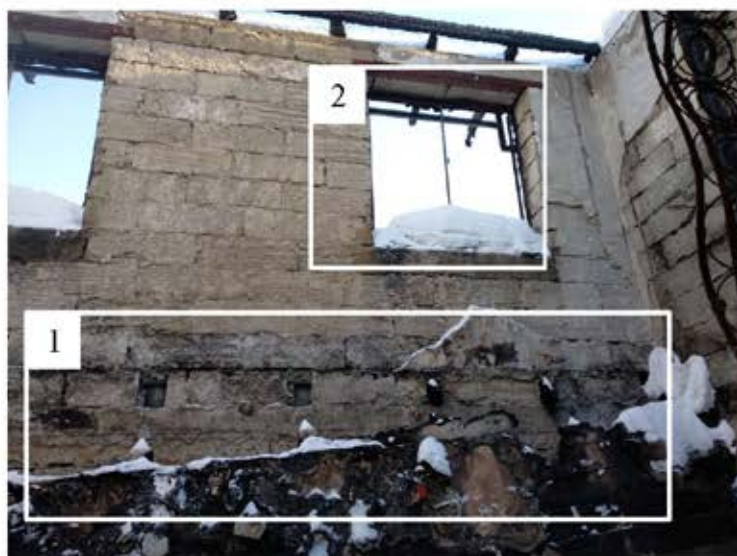
Фото 7. Фрагмент вида помещения. Дефекты: 1-обвал межэтажного перекрытия, 2-повреждение оконных блоков.
