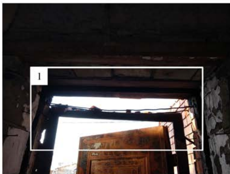
Фото 4. Фрагмент вида дверного блока. Дефекты: 1-повреждение монтажного шва и креплений.
