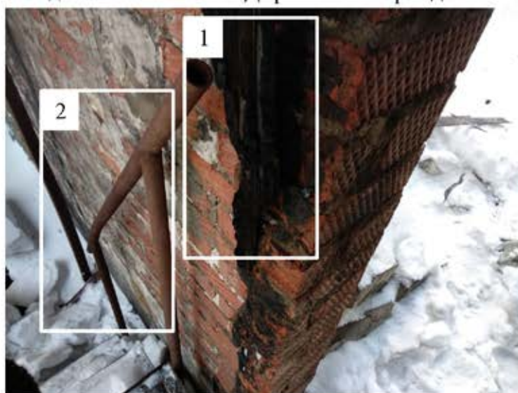
Фото 6. Фрагмент вида лестницы и двери. Дефекты: 1-обугленный элемент двери, 2-коррозия на поручне лестницы.
