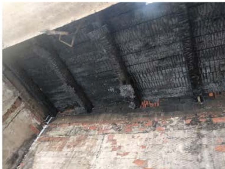
Фото 1. Фрагмент вида межэтажного перекрытия. Дефекты: 1-обугленные элементы.
