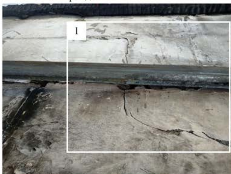
Фото 12. Фрагмент вида стены. Дефекты: 1-трещина в газобетонных блоках.
