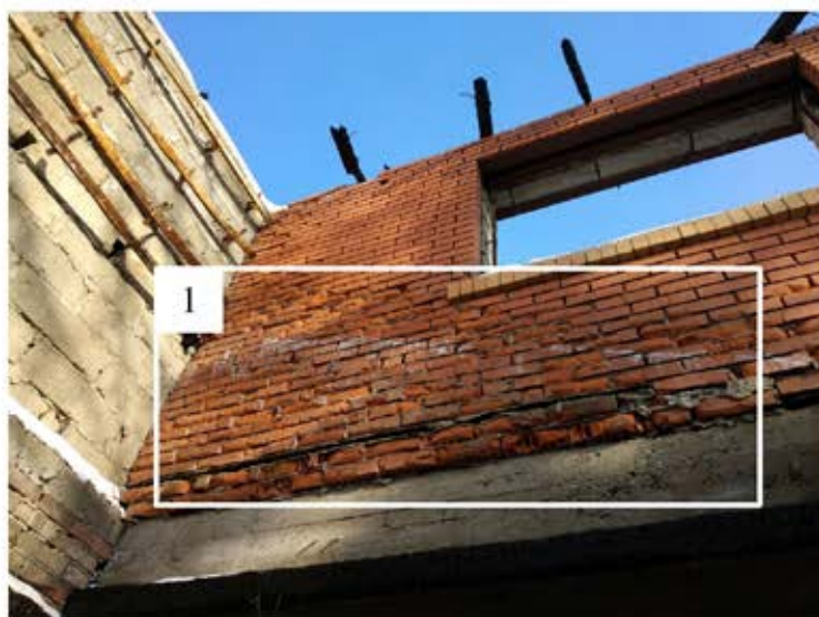
Фото 13. Фрагмент вида фасада. Дефекты: 1-сколы облицовочного кирпича.
