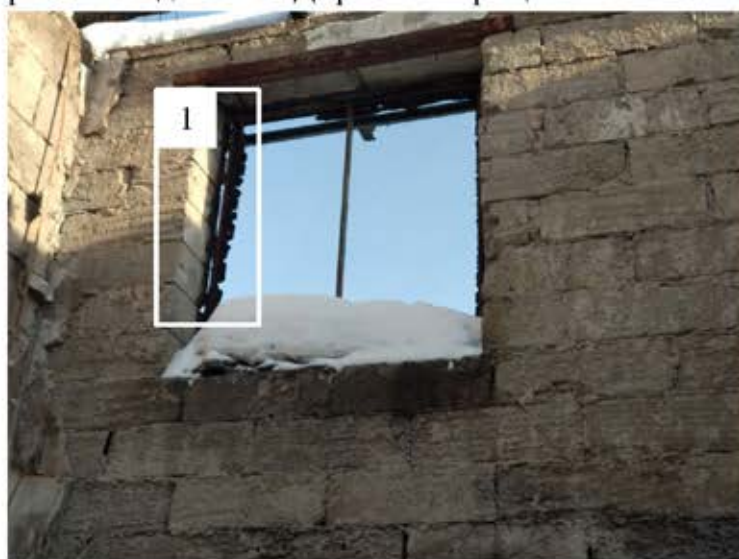
Фото 18. Фрагмент вида окна. Дефекты: 1-обугленные элементы оконного блока.
