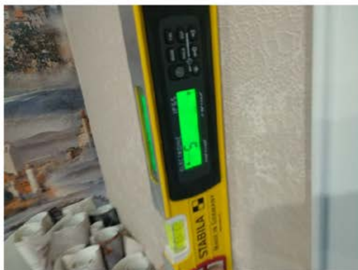
Фото 3. Отклонение от вертикали поверхности стены до 5 %.
