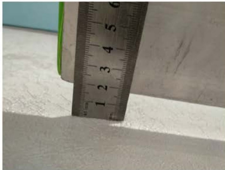
Фото 2. Неровность поверхности стены до 19,5 мм на 2 м.
