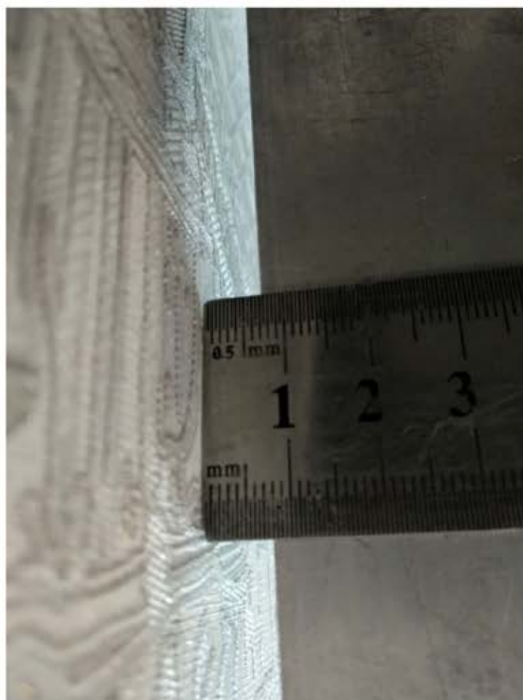
Фото 16. Неровность поверхности стены до 8,0 мм на 2 м.
