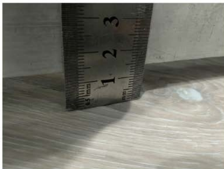
Фото 4. Неровность поверхности пола до 14,5 мм на 2 м
