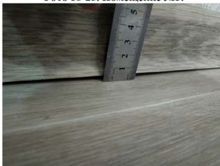
Фото 18. Зазор между плинтусом и поверхностью пола до 5 мм.
