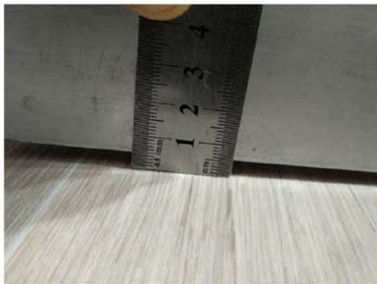
Фото 17. Неровность поверхности пола до 6,5 мм на 2 м.
