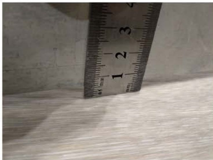
Фото 9. Неровность поверхности пола до 6,5 мм на 2 м.
