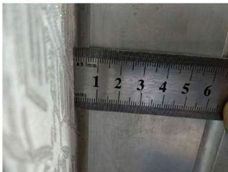
Фото 15. Неровность поверхности стены до 6,0 мм на 2 м.
