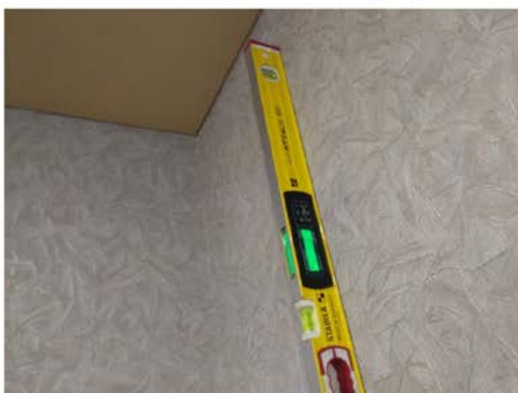
Фото 8. Отклонение от вертикали поверхности стены до 3 %
