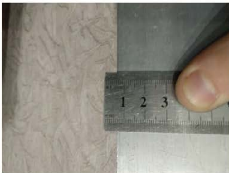
Фото 7. Неровность поверхности стены до 6,5 мм на 2 м.
