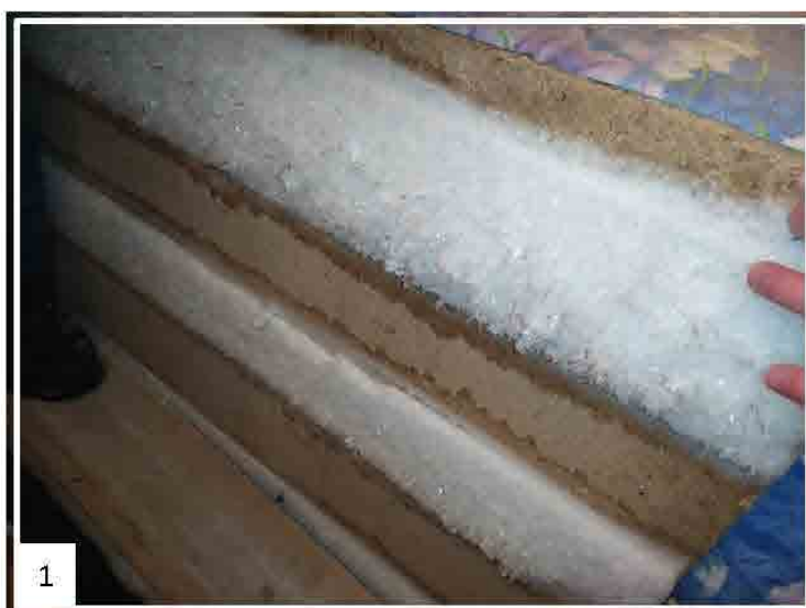
Фото 8. Фрагмент вида пола. Дефекты: 1-наледь.
