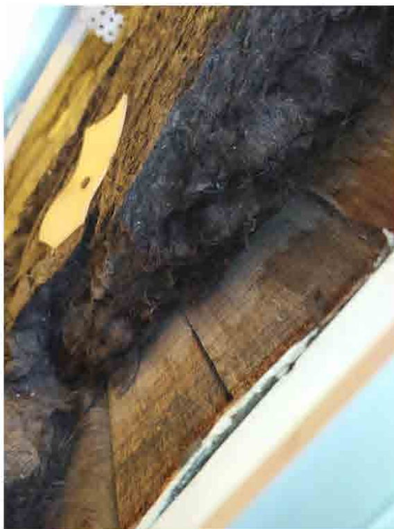
Фото 5. Фрагмент вида стены. Дефекты: 1-след увлажнения.
