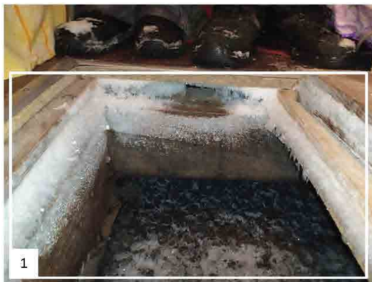
Фото 9. Фрагмент вида пола. Дефекты: 1-наледь.
