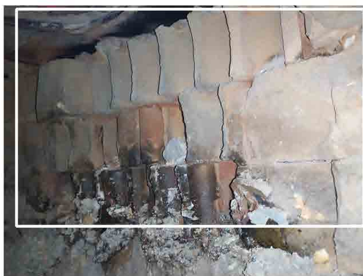
Фото 17. Фрагмент вида печи отопления. Дефекты: 1-разрушение кирпича.
