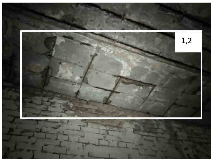
Фото 13. Дефекты: 1,2- коррозия арматуры, разрушение защитного слоя
