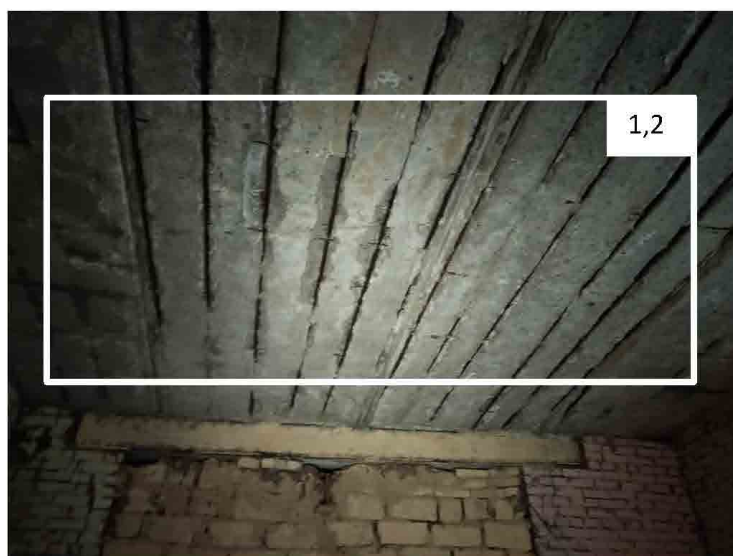
Фото 14. Дефекты: ,2- коррозия арматуры, разрушение защитного слоя
