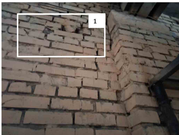
Фото 4. Дефекты: 1- деформация кладки
