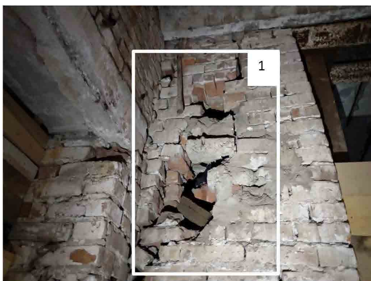
Фото 11. Дефекты: 1- разрушение кладки (выпадение кирпичей)
