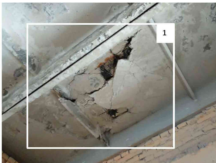
Фото 5. Дефекты: 1- локальное разрушение ж\б плиты
