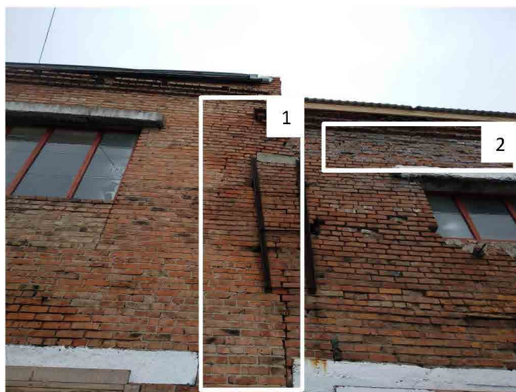
Фото 17. Дефекты: 1- трещина на всю высоту ; 2 - разрушение кирпичей
