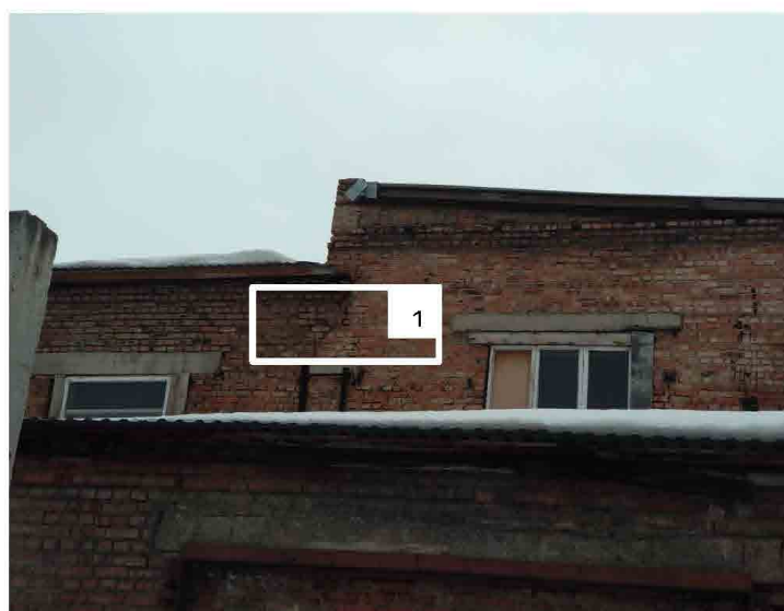
Фото 18. Дефекты: 1- сквозная трещина
