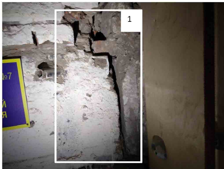
Фото 1. Дефекты: 1- сквозная трещина
