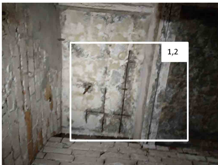
Фото 8. Дефекты: 1,2- коррозия арматуры, разрушение защитного слоя
