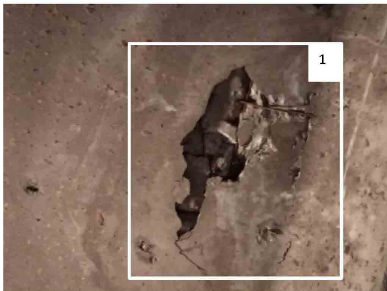
Фото 7. Дефекты: 1- разрушение ж/б плиты
