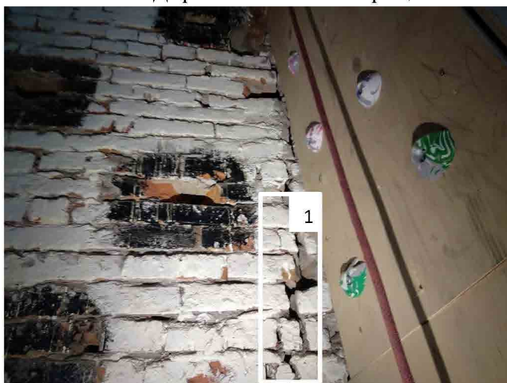
Фото 2. Дефекты: 1- сквозная трещина
