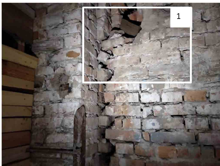
Фото 10. Дефекты: 1- деформация кладки
