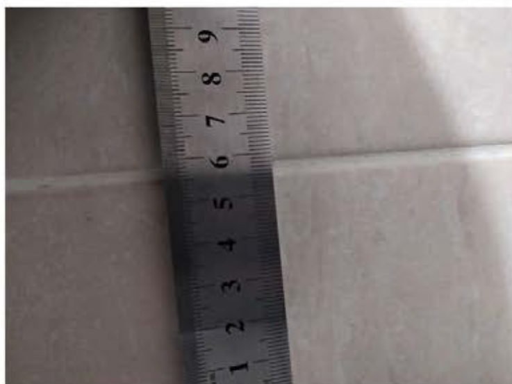
Фото 15. Вид стены. Ширина шва.
