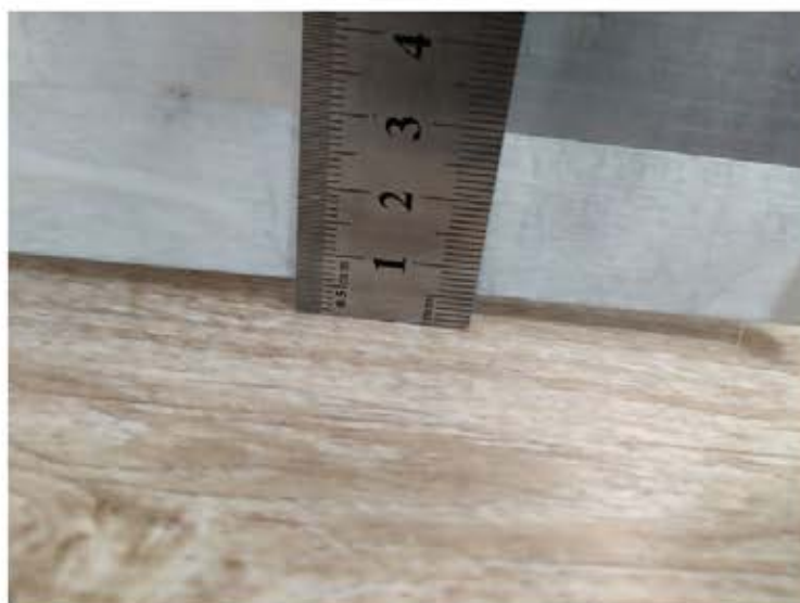
Фото 3. Вид пола. Дефекты: 1- неровность поверхности.
