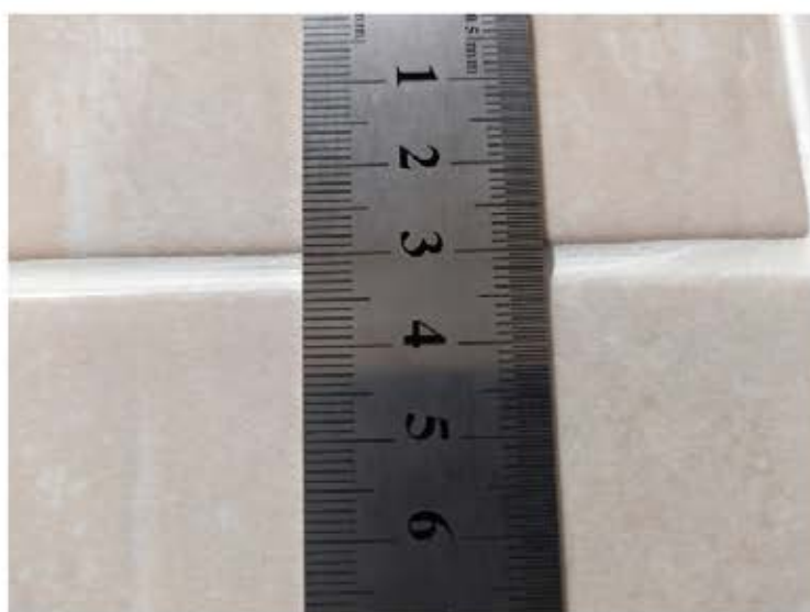
Фото 14. Вид стены. Ширина шва.
