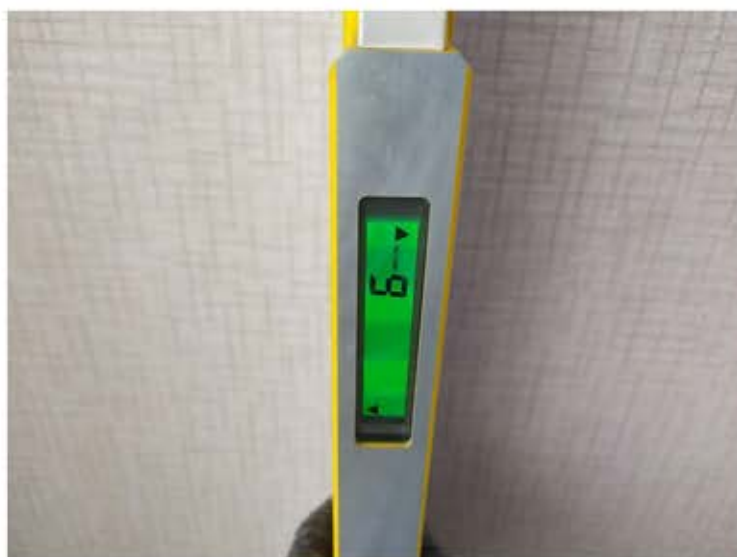
Фото 2. Вид стены. Дефекты: 1- отклонение поверхности от вертикали.
