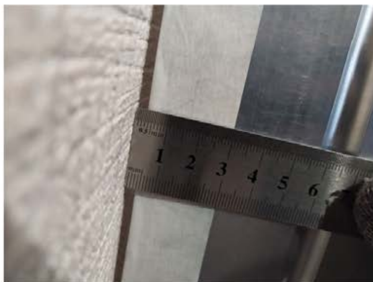
Фото 8. Вид стены. Дефекты: 1- неровность поверхности.
