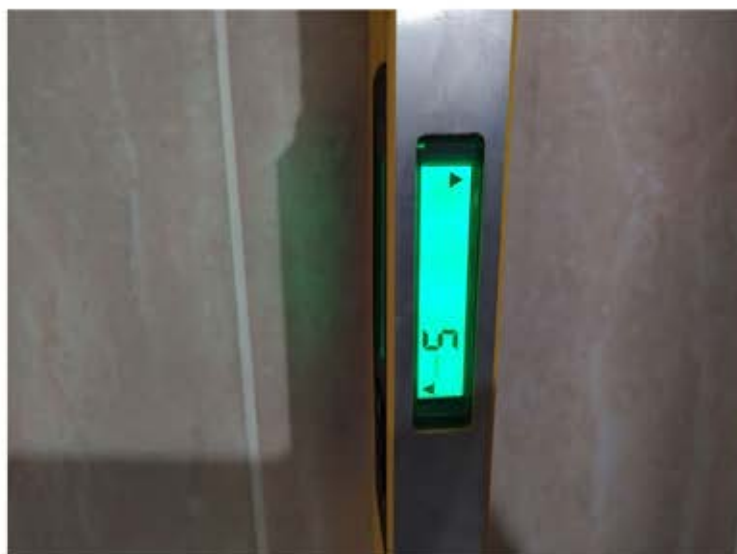
Фото 13. Вид стены. Дефекты: 1- отклонение поверхности от вертикали.
