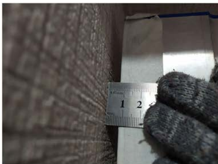
Фото 9. Вид стены. Дефекты: 1- неровность поверхности.
